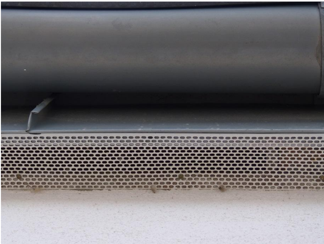
Bild 10: Mit Gitter verschlossene Öffnungen im Traufbereich des LIDL-Lebensmittelmarktes
