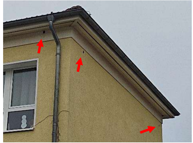
Abb. 5: Spechtlöcher in der Fassade des Hortgebäudes
