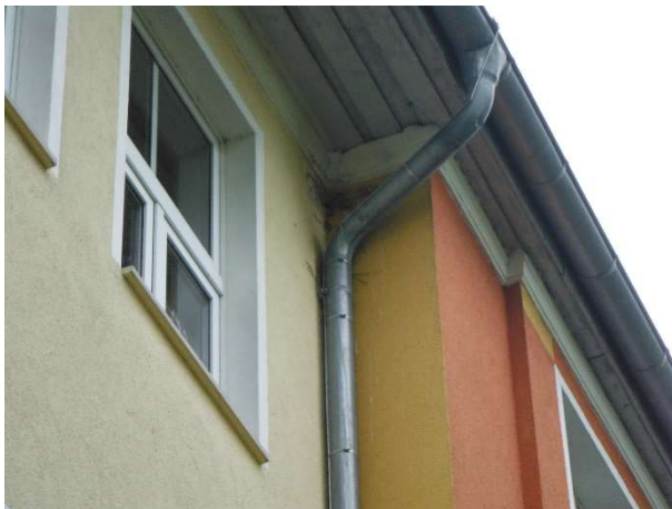
Abb. 11: Nestrückstände der Ringeltaube am Schulhauptgebäude
